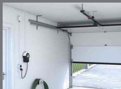
Řídicí jednotka v prostoru garáže
